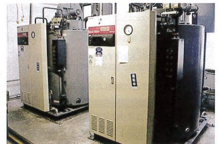
▲ボイラーは1tが2基(稼働13年目)
