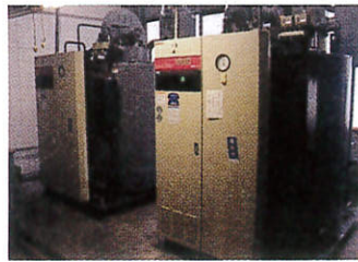
▶ボイラーは1tが2基(稼働13年目)
